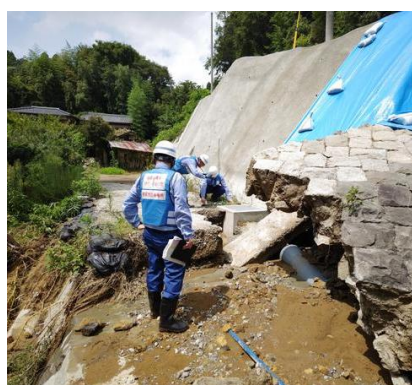
道路法面の被災状況調査 (千葉市)
