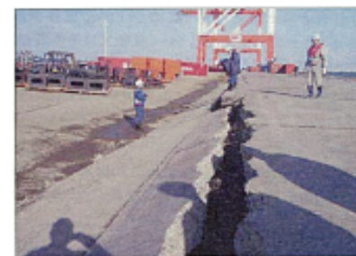
液状化で大きな段差が生じた北ふ頭の岸壁
