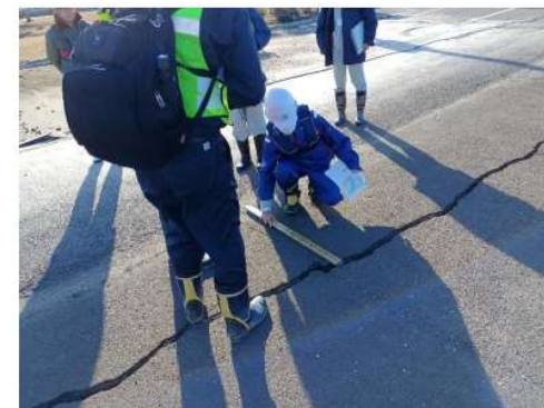
金沢市の港湾施設の被災状況調査(R1.1.4 活動記録)
