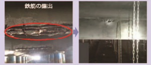
棧橋式岸壁の老朽化状況と対策
