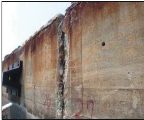
上部工の劣化状況
