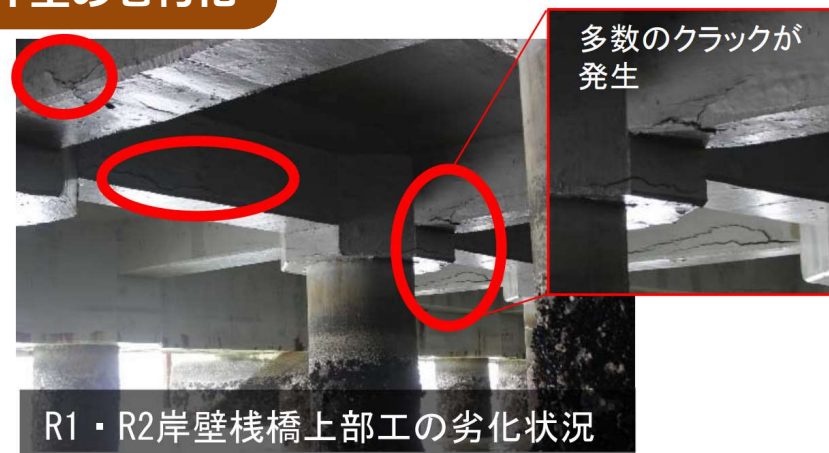
岸壁の老朽化
